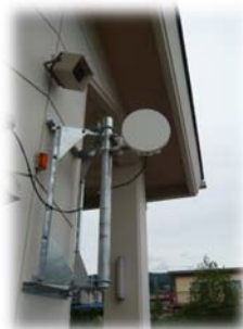
【FWA設置状況】
