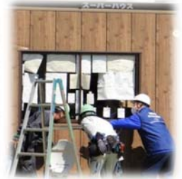
【南三陸町：VSAT設置】
